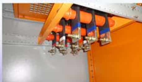
Entrada de cabos
